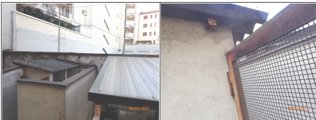
Figura 2.2: tettoia in cortile in fibrocemento contenente amianto
