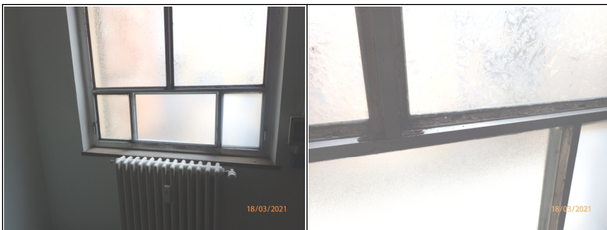
Figura 2.11: piano secondo - stucco ferma vetri su infissi in ferro contenente amianto
