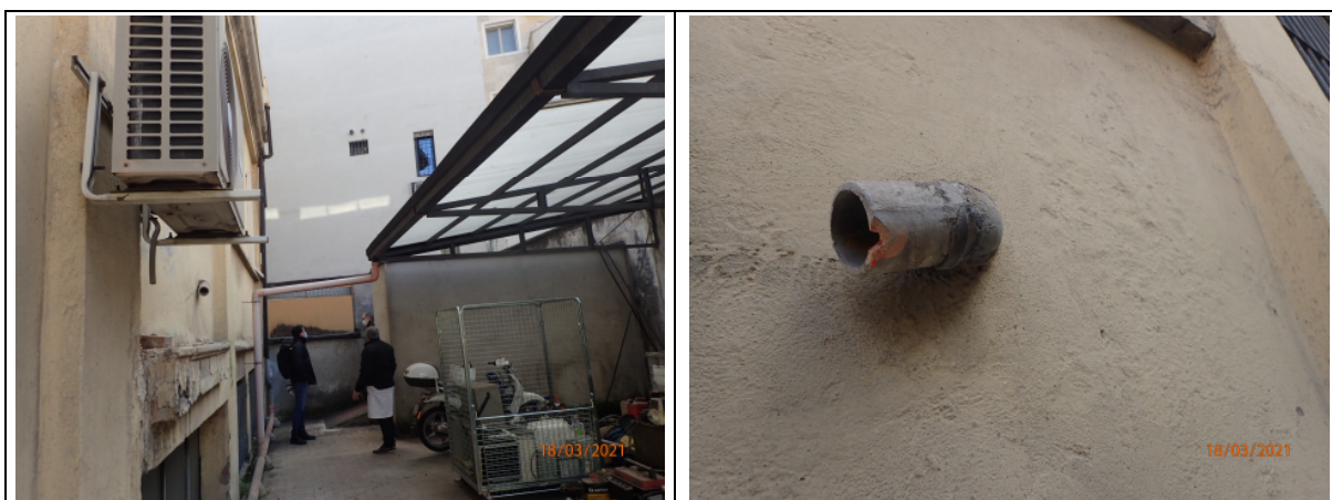
Figura 2.1: canale di scolo in parete in fibrocemento contenente amianto
