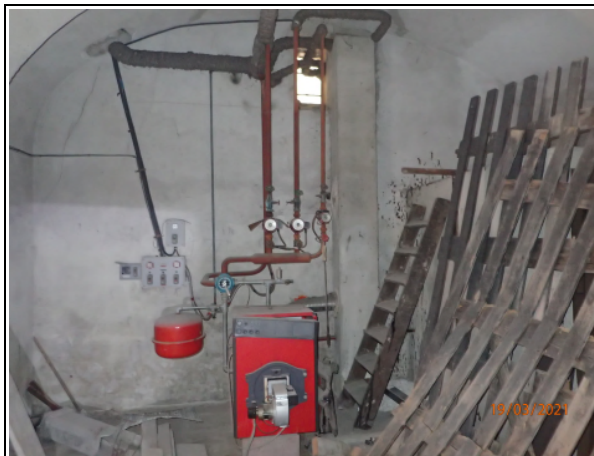
Figura 2.1: locale CT - caldaia del 1994
