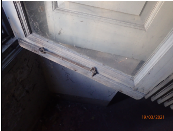
Figura 2.5: tutti i piano – assenza di stucco alle finestre
