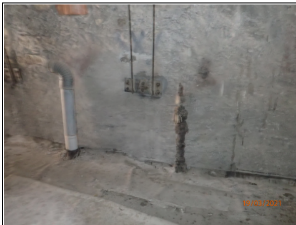
Figura 2.7: piano sottotetto – tubazione coibentata con cascame
